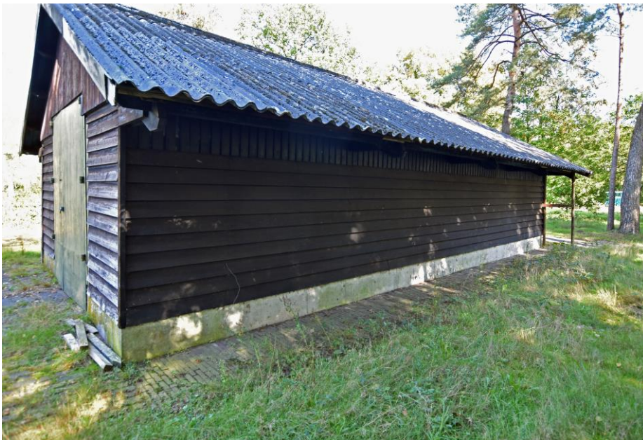
Gebouw 12. Overzicht van de van de zuidgevel van de lattenloods. Aan de bovenzijde zijn de verticale latten zichtbaar, die op 2 cm uit elkaar zijn geplaatst ten behoeve van de ventilatie. Het deel eronder is voorzien van horizontale planken, die onderling ook een ventilatieruimte hebben van 2 cm. Dit deel is 1,70 m hoog, terwijl het volgens het bestek 1,60 meter hoog moest zijn.
