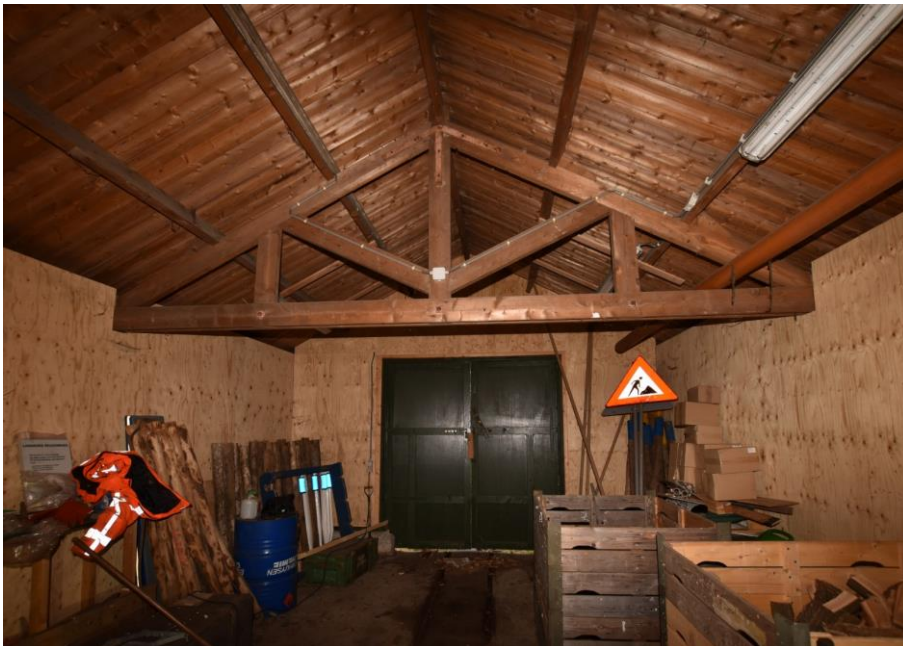
Gebouw 12. Overzicht van het interieur gezien naar het westen. Bij de neuten van de deuren is te zien dat de deuropening oorspronkelijk minder breed was. De deuropening is ook hoger dan de deuropening in de oostgevel. Dit geeft aan dat de deuropening vergroot is.
