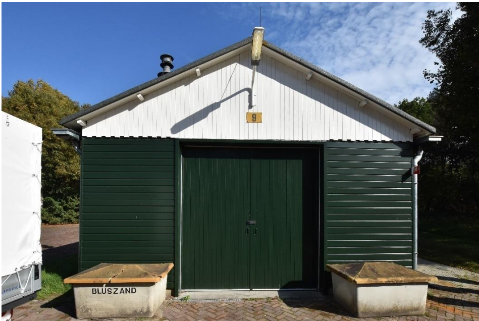
Gebouw 9. Overzicht van de westgevel van de schijvenloods. De planken van de gevel zijn vervangen. Tot enige jaren geleden waren hier vóór de dubbele deur nog de resten van de smalspoorbaan zichtbaar.
