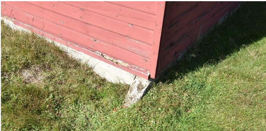
Gebouw 11. Detail van de hoek tussen de zuid- en oostgevel. Hier is het betonnen fundament zichtbaar waarop de loods is geplaatst. Het uitstekende deel van het fundament is een restant van het rond 1967 afgebroken zuidelijke deel.
