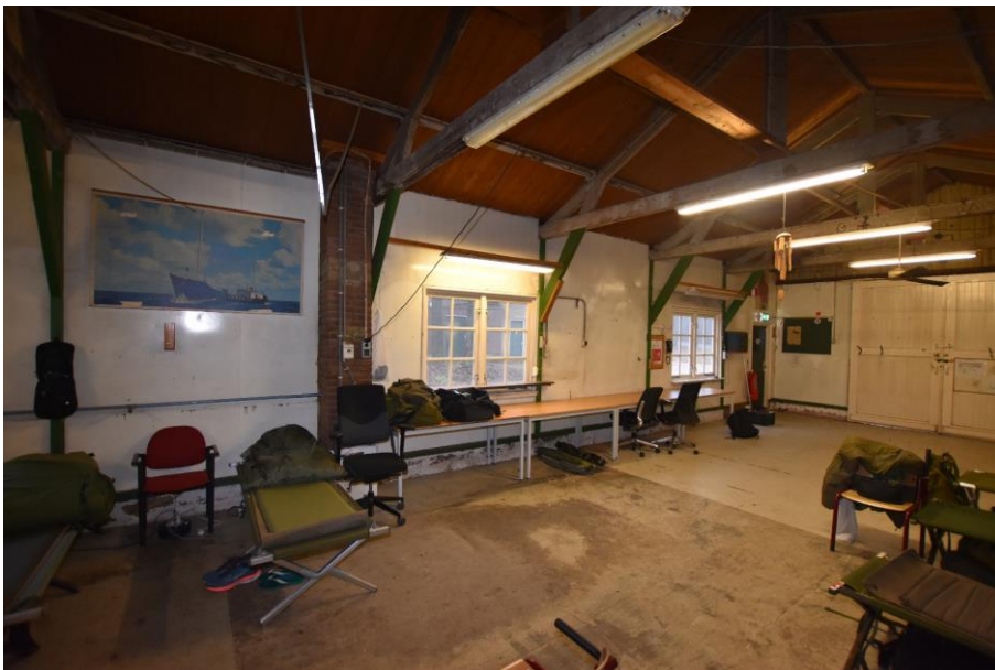
Gebouw 9. Overzicht van de zuidwand van de lods met links van de vensters een rookkanaal dat bij een kachel zal hebben behoord. De schoorsteen is afgebroken tot vlak onder het dakvlak. In het tussenlid is een vergelijkbaar rookkanaal aanwezig.
