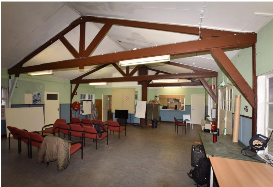
Gebouw 11, ruimte 009. Overzicht van de kantine gezien naar het noorden. De kapconstructie bestaat uit hangspanten die naar de stijlen van de wandconstructie zijn afgeschoord. Makelaar en schoren zijn geklemd aangebracht tussen de dubbele trekplaten.
