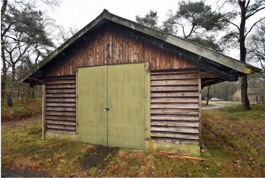
Gebouw 12. De westgevel van de loods. De deuropening is naderhand vergroot, waarbij de huidige dubbele deur is geplaatst. Deze vervangt de oorspronkelijke dubbele deur, die even groot was als de die aan de oostzijde.
