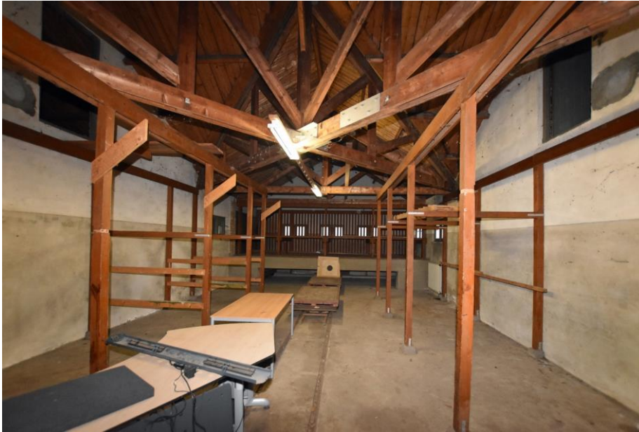
Gebouw 10, ruimte 2. Overzicht van de centrale opslagruimte gezien in oostelijke richting. Achterin is de houtopslag. Aan de linker- en rechterzijde bevinden zich rekken voor de opslag van schietschijven. In het midden van de vloer is het smalspoor zichtbaar.
