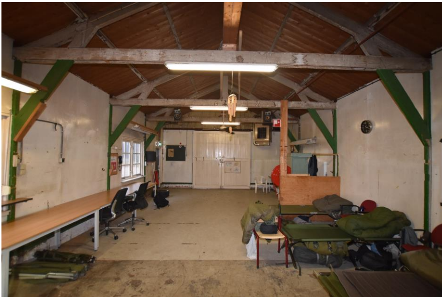
Gebouw 9. Overzicht van het interieur van de schijvenloods, gezien in de richting van de dubbele toegangsdeur. De kapconstructie bestaat uit hangspanten die op de wandstijlen zijn afgeschoord. De wanden zijn aan de binnenzijde met plaatmateriaal afgedekt, waardoor het niet te zien is hoe de binnenzijde van de wanden was afgewerkt. Alleen bij de topgevel heeft men geen plaatmateriaal aangebracht. Zie hiervoor de volgende afbeelding.
