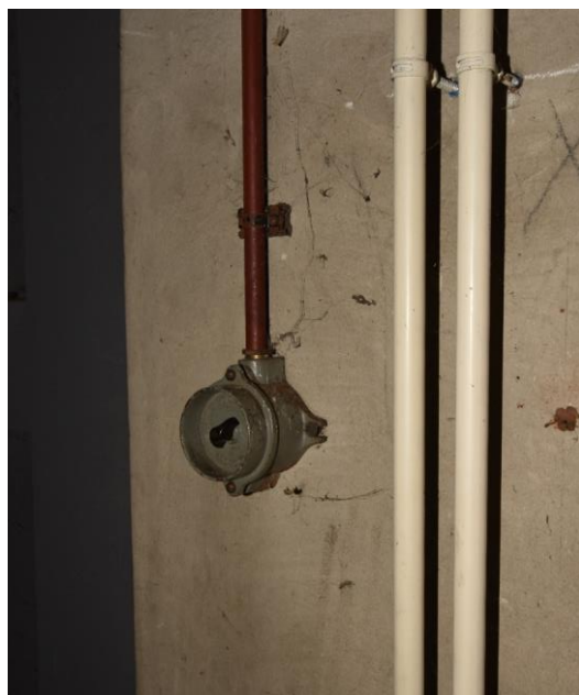
Gebouw 10, ruimte 3. Detail van de lichtschakelaar in het vertrek. Deze schakelaar is één van de weinige behouden schakelaars uit de bouwtijd.
