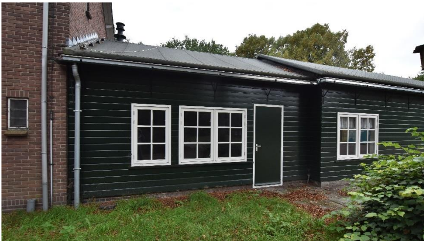
Gebouw 9. De noordgevel van het tussenlid. De gehele gevel is enige jaren geleden hersteld, waarbij de vensters en deur zijn vervangen.
