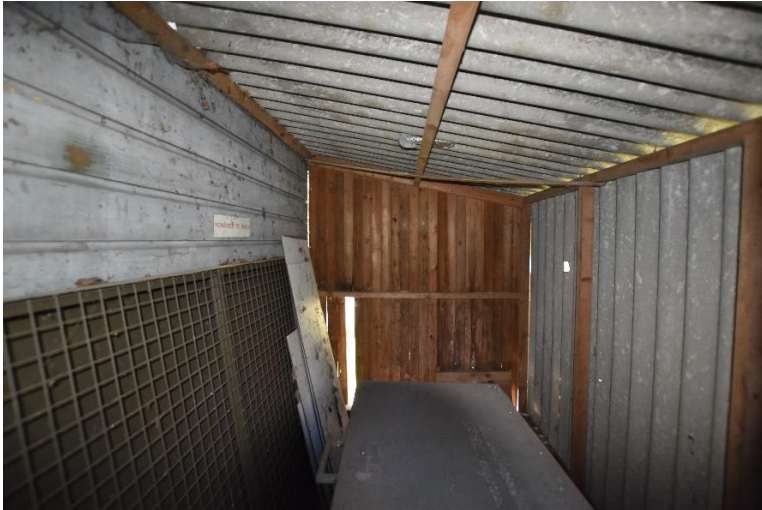
Gebouw 11. Zicht op het interieur van de aanbouw tegen de noordgevel. Links is de oorspronkelijke buitengevel van de loods zichtbaar. Deze is wit geschilderd. Dit geeft aan dat de loods voordat de uitbouw werd geplaatst wit was geschilderd.
