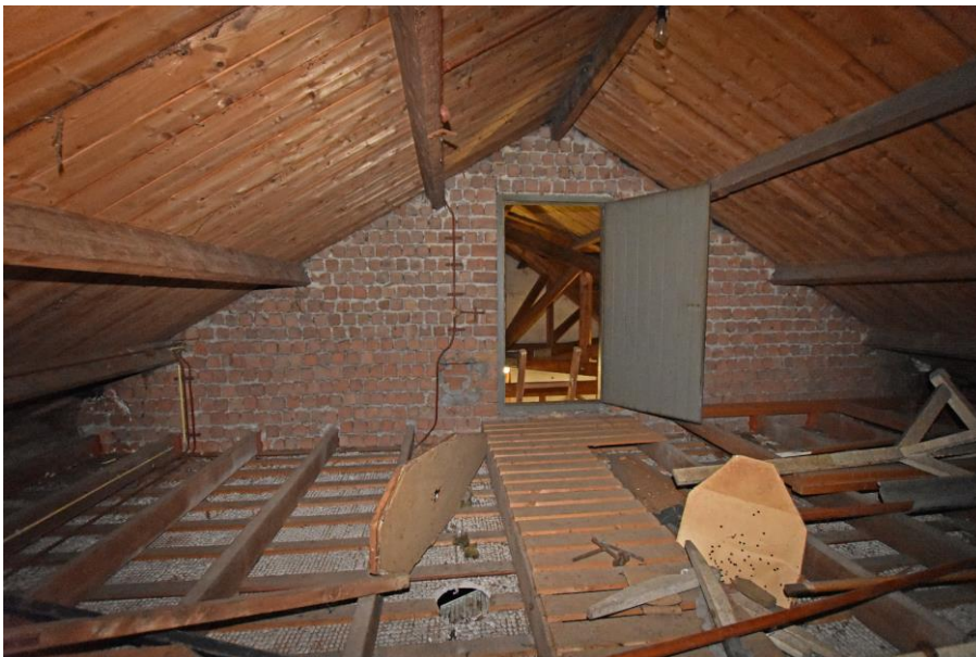
Gebouw 10, zolder zuidvleugel. De zolder gezien in de richting van de centrale ruimte (ruimte 2). De gordingen zijn opgelegd in de dwarsmuren van het centrale gedeelte. Deze muren zijn deels steens en deels halfsteens dik. De hier zichtbare muur is steens dik in patijtsverband opgetrokken. De dwarsmuren van de zolder zijn met stenen in maasformaat uitgevoerd. Op de zolderbalken liggen onderdelen van de schietbanen.
