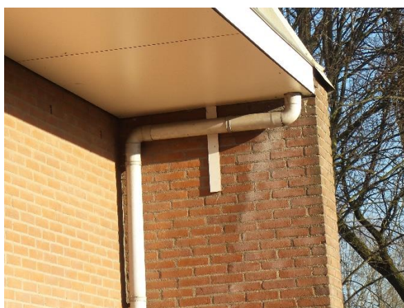
Niet correct gemonteerde beplating
