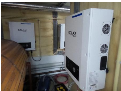
Separate elektrische installatie in de technische ruimte van het activiteitencentrum.
