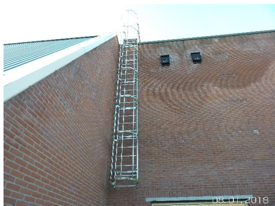
Vocht doorslaande geveldelen
