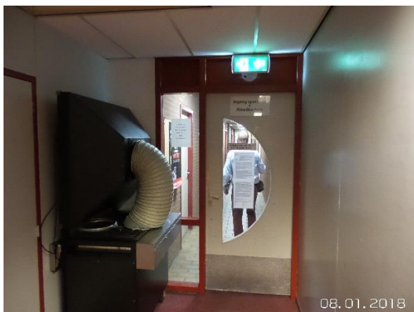
Niet 30 minuten brandwerend uitgevoerde beglazing
