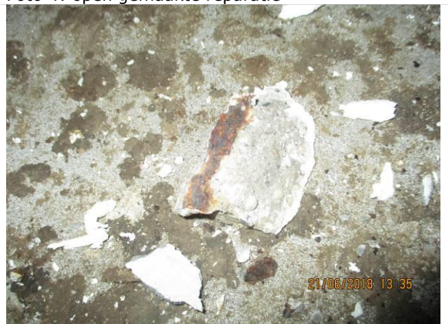
Foto 6: carbonatatie tekenen op afgehakt beton
