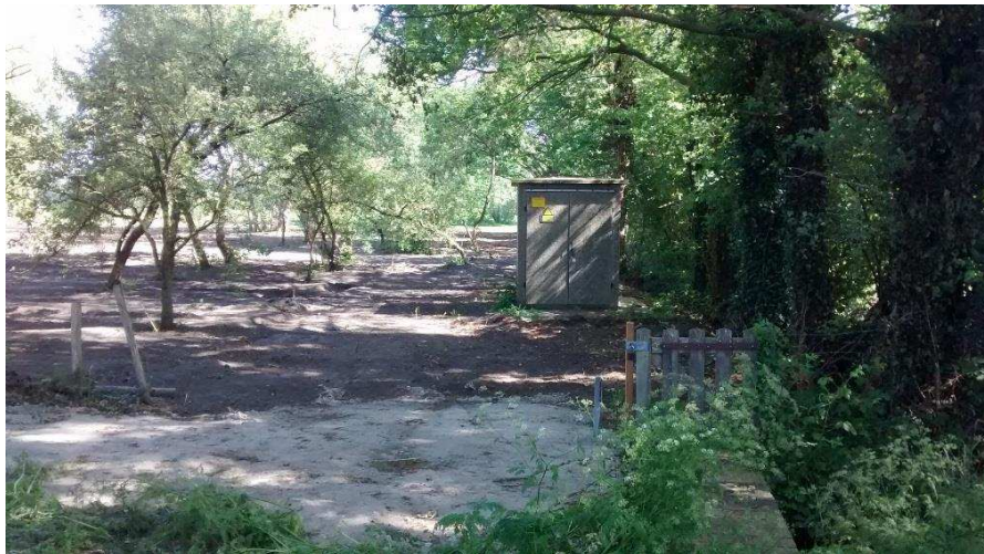
Trafo nabij de Emelaarseweg met naast gelegen ontsluiting en kabeltracé.
