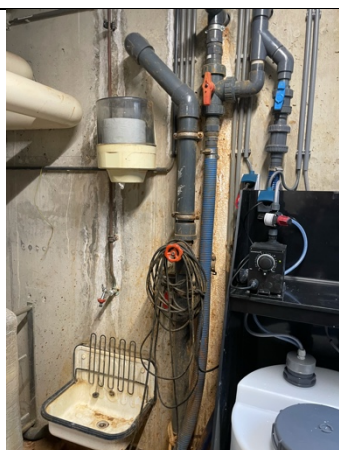
31 Appendages zijn in redelijke staat. De leksporen hebben een bouwkundige oorzaak.
