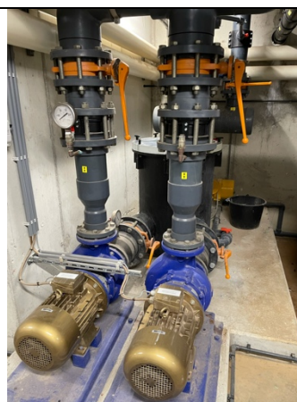
32 Door reparatie en vervanging van onderdelen blijft de waterbehandeling goed werken.
