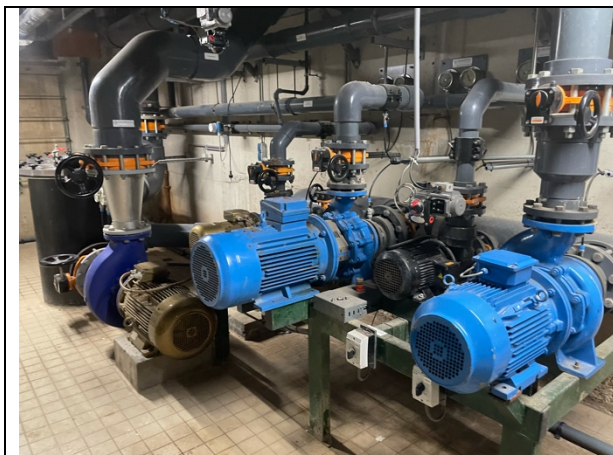
27 Er is een mix van wat oudere en nieuwe pompen aanwezig. Ze worden goed onderhouden.
